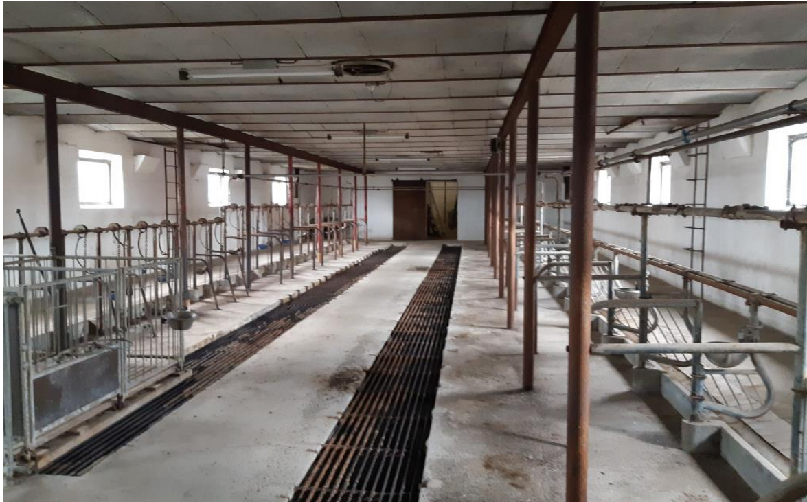
Gl. kostald. Bindestald med afløbsrist bag båsene. Hverken gulv- eller loftkonstruktion er brugbart i en nutidig svinestald.
